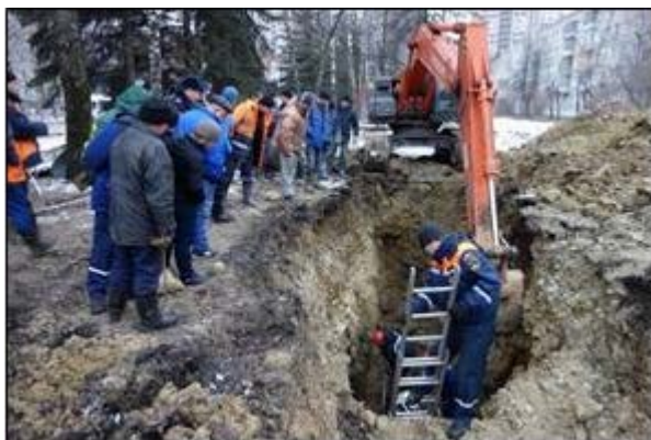
Рис. 1. Производство работ в котловане, проводимое с грубыми нарушениями правил охраны труда при земляных работах
